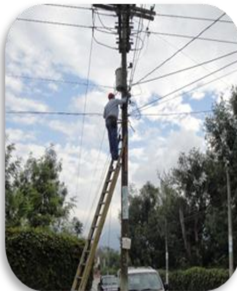
LOCALIZACIÓN DE LOS EQUIPOS REGISTRADORES DE INTERRUPCIONES
