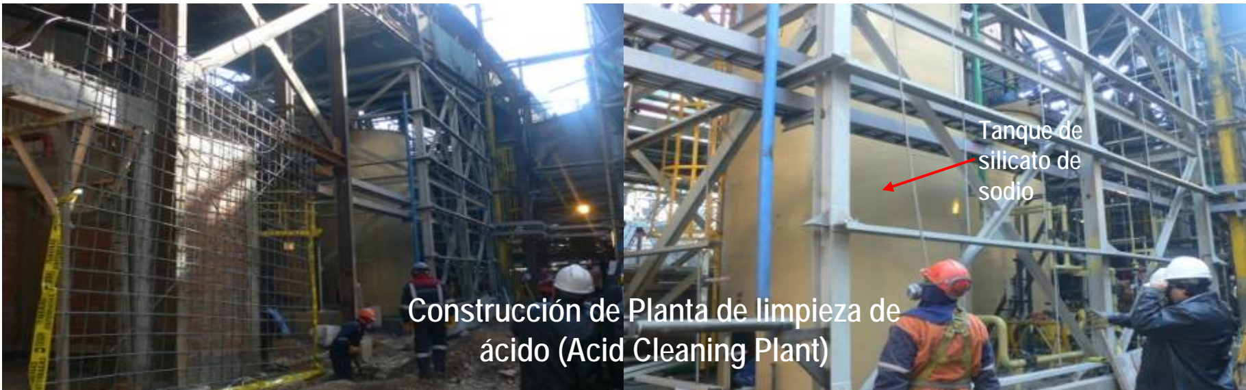
Ductos y conexiones de gas, agua para enfriamiento, y despacho de ácido sulfúrico
