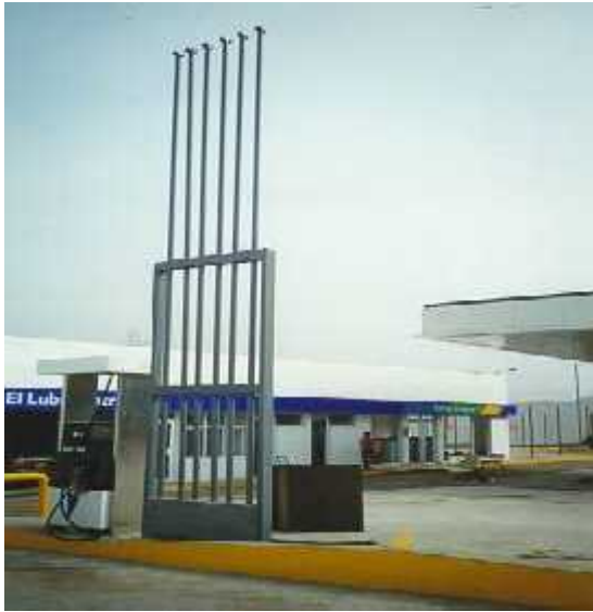
Tubos de ventilación de los tanques
