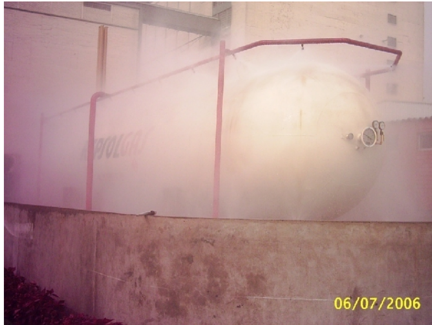
OPERACIÓN DE ASPERSORES
