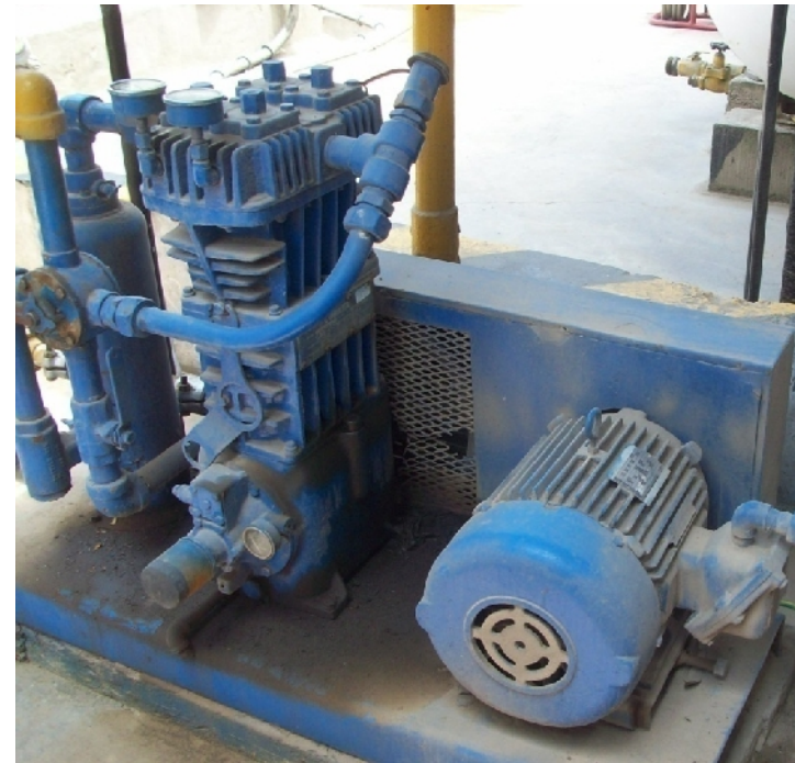
COMPRESOR PARA GLP
