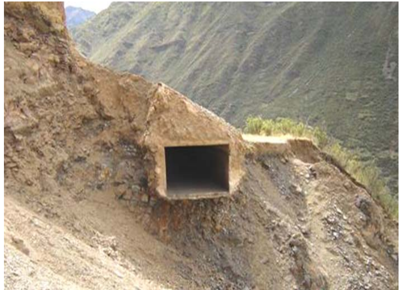
Canal de conducción colapsado, contingencia que afecta la continuidad del servicio eléctrico.
