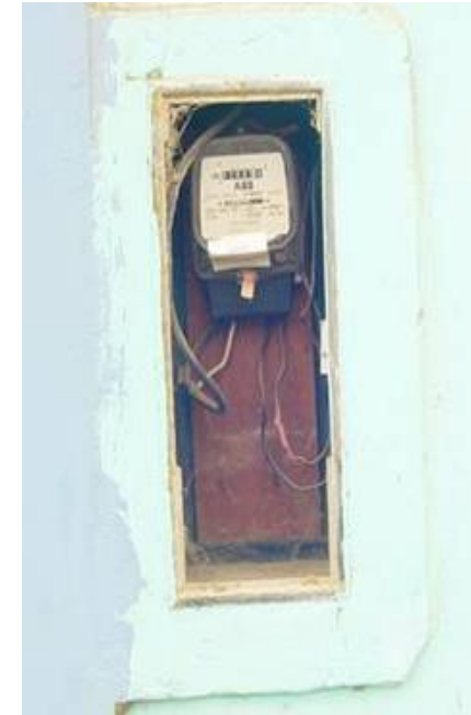
Medidor sin tapa
