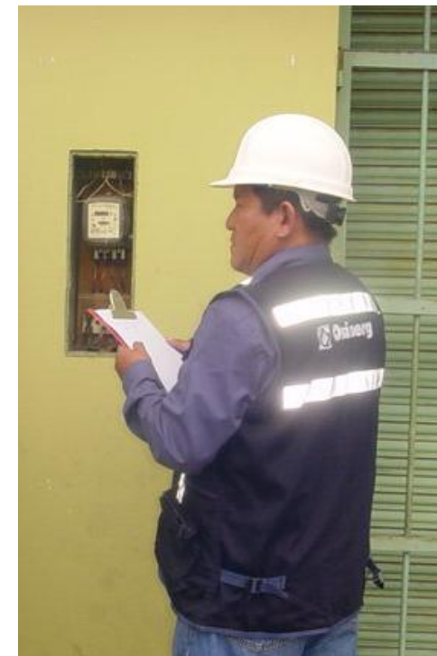
Inspección de Instalaciones de BT.
