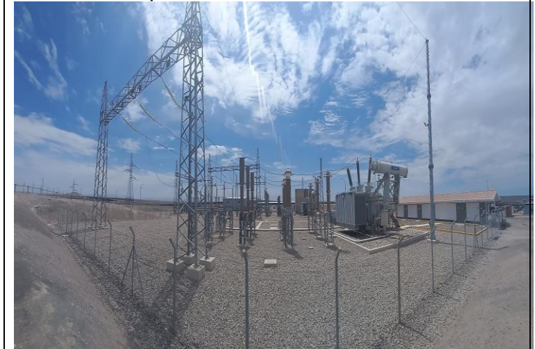
Vista panorámica de la Ampliación de la S.E. Rubí 33/220 kV
