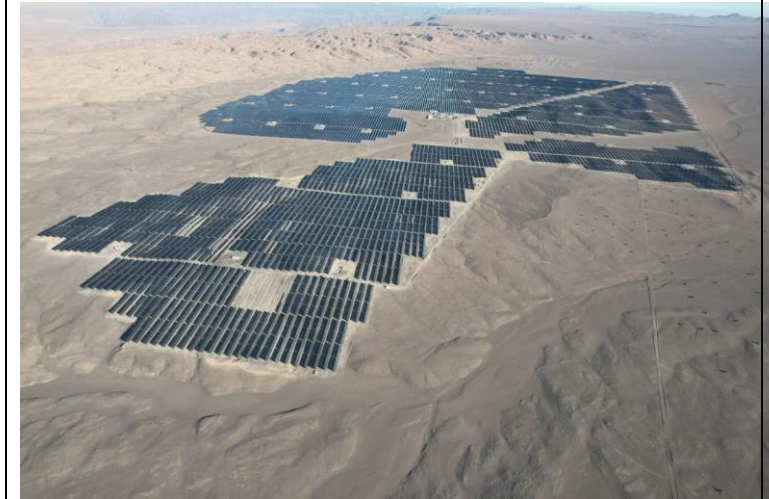
Vista panorámica de la Central Solar Clemesí
