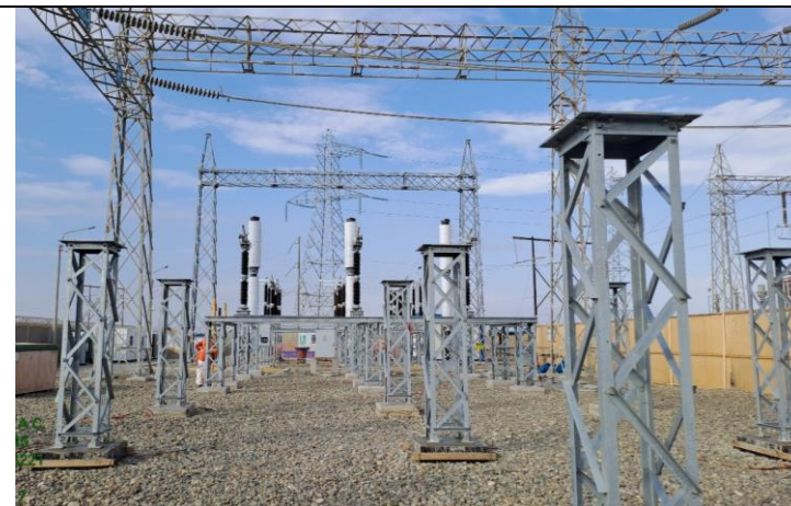
Patio 220 kV Ampliación S.E. Pariñas
