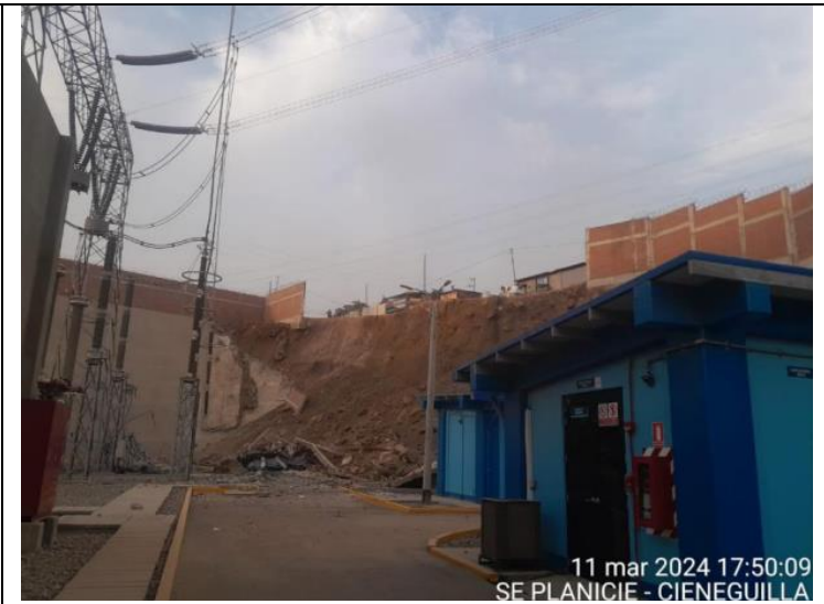
Colapso de muro perimetral S.E. La Planicie
