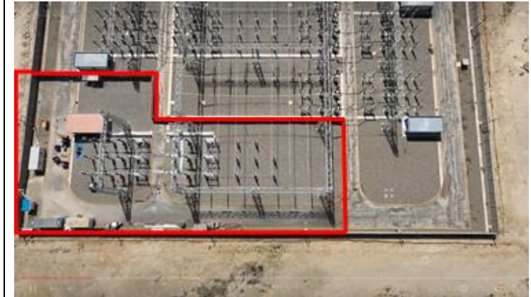
Vista panorámica de la Ampliación de la S.E. Pariñas
