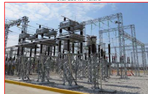
S.E. Piura - Compensación Reactiva
