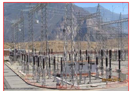
Celda de Llegada en S.E. Kiman Ayllu
