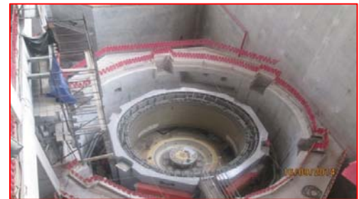
Trabajo en Casa de máquinas
