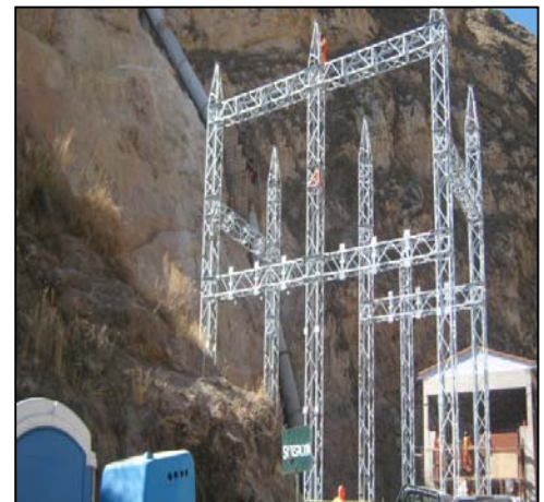
Pórtico de la S.E. Canchayllo
