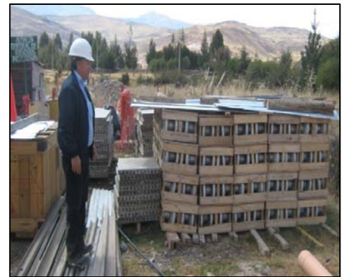
Suministros de aisladores de la L.T.
