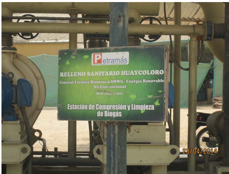
Sistema de compresión y limpieza de Biogás
