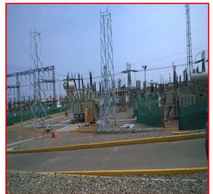
Autotransformador S.E. Trujillo
