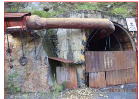
Ventana de acceso Túnel de conducción C.H. Ángel III
