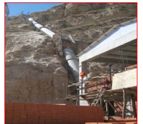
Vista de la Tubería Forzada-Casa de Máquinas
