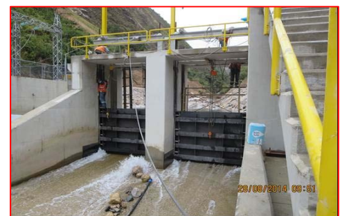
Compuertas del barraje móvil
