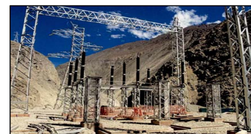
Patio de llaves 220 KV
