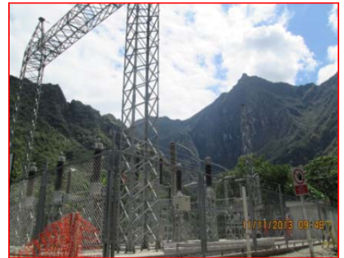
Pórtico en el que se conectará la central al SEIN
