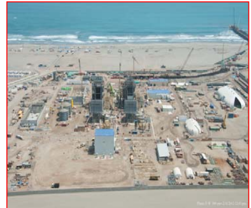
Vista de Frente de la Central
