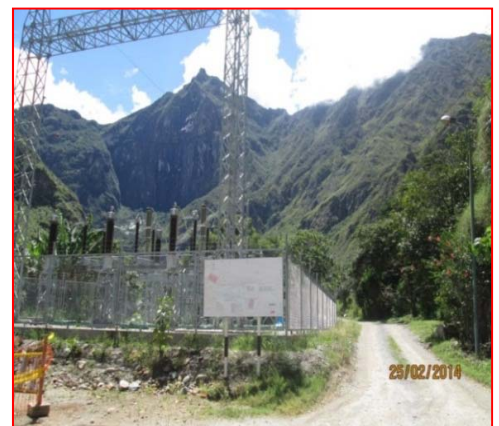
Subestación de Salida
