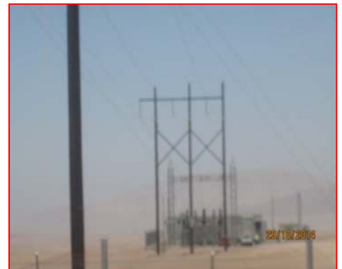
L.T. 22,9 Moquegua FV - S.E. Panamericana Solar
