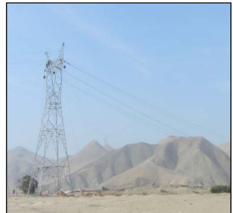
Estructura Autosoportada de la L.T. 500 kV S.E. Fénix – S.E. Chilca
