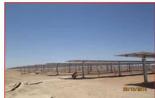
Módulos fotovoltaicos instalados
