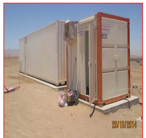
Casa de Control - P.S.F. Moquegua
