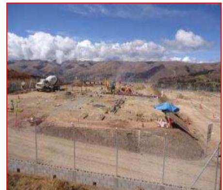
Vista Panorámica de S.E. Abancay Nueva
