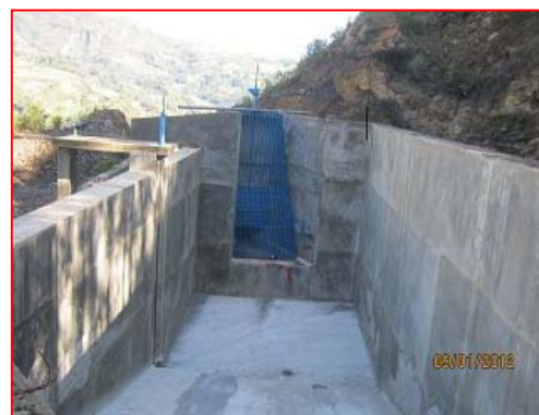
Rejillas de Cámara de Carga
