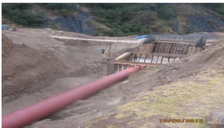
Vista de la Tubería Forzada
