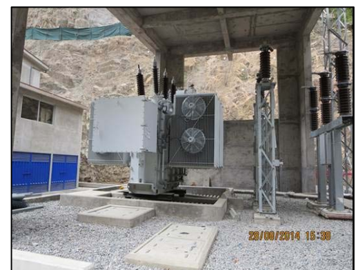
Vista del Transformador
