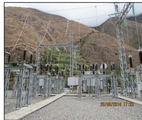
Vista Pórticos S.E. Runatullo III
