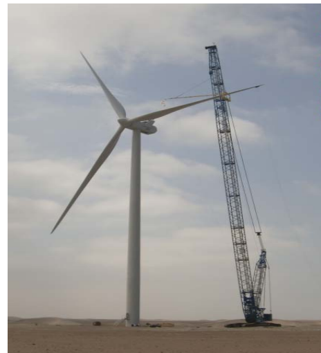
Ilustración 8: Aerogenerador del P.E. Cupisnique
