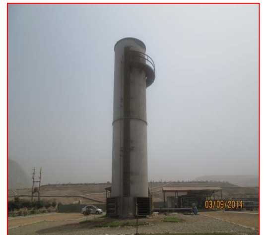
Estación de quemado de gas
