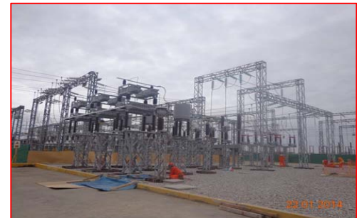
Equipos de la Compensación Reactiva S.E. 220 kv Piura Oeste
