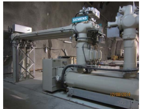
Subestación sistema GIS, en caverna
