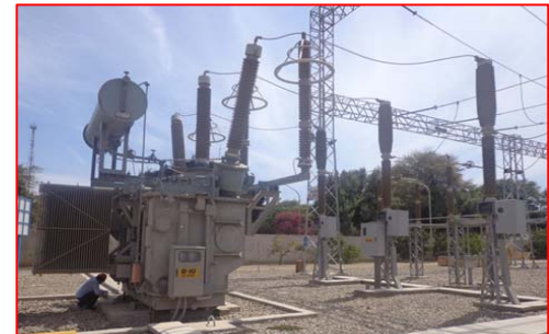
Reactor R-10 - celda de conexión en 220 kv S.E. 220 kv Talara
