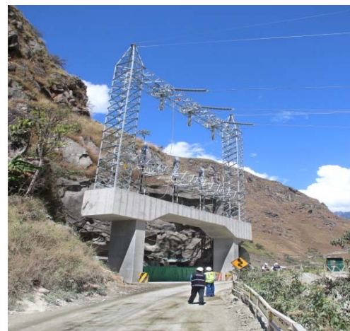
Pórtico 220 kV L-20149 Santa Teresa-Suriray
