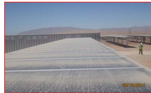
Vista de los módulos instalados
