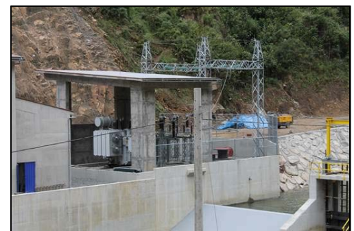
Vista de la S.E. Runatullo II
