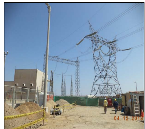
Pórtico de Salida y Subestación GIS 500 kV
