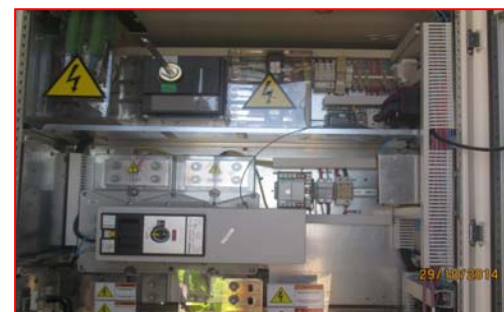
Vista del conexionado del inversor
