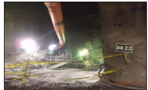
Caverna de Transformadores
