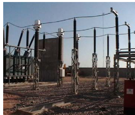
Ubicación de Transformador
