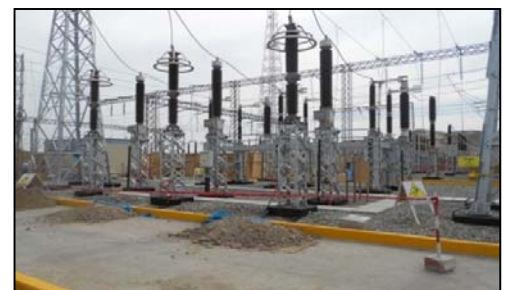
Celda de llegada en S.E. Huacho
