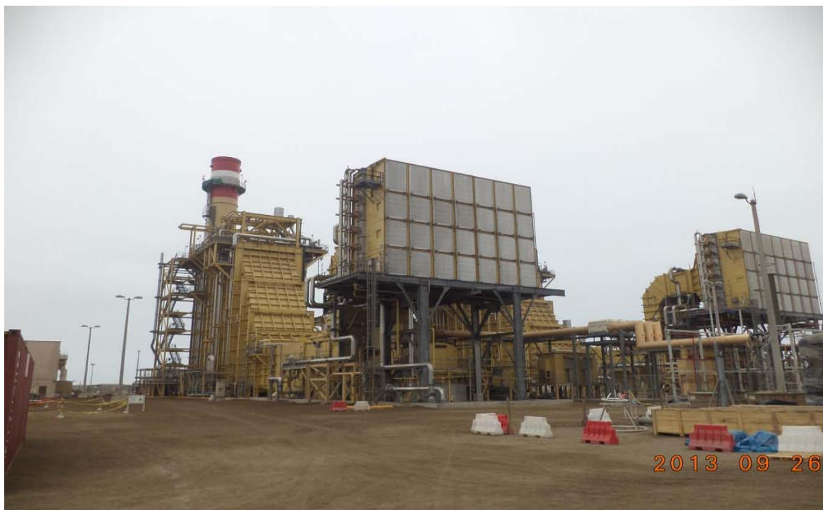
Ilustración 5: Turbinas a Gas y Turbinas de Vapor - C.T. Chilca (534,3 MW)
