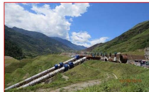
Conducto Forzado unidades 1 y 2
