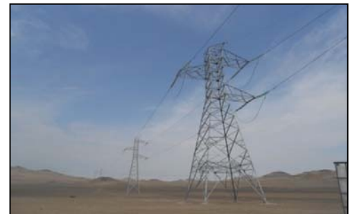
L.T. 220 kV S.E. Cheves-S.E. Huacho
