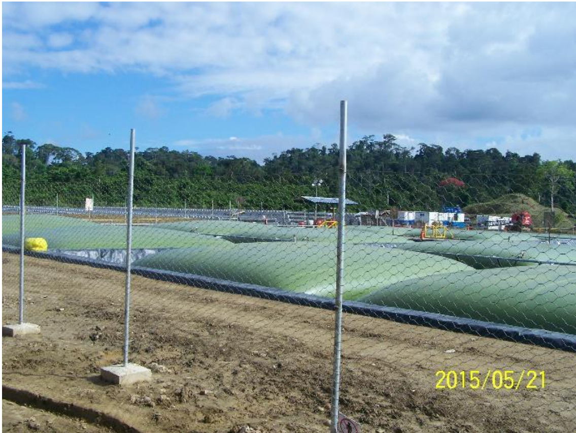
Foto 03. Ticumpinía: Vista parcial de área de almacenamiento de combustible diésel, se aprecia parte de los bladders que GSP viene acondicionando en Ticumpinía. Se aprecia que tiene ya instalado dos surtidores.
