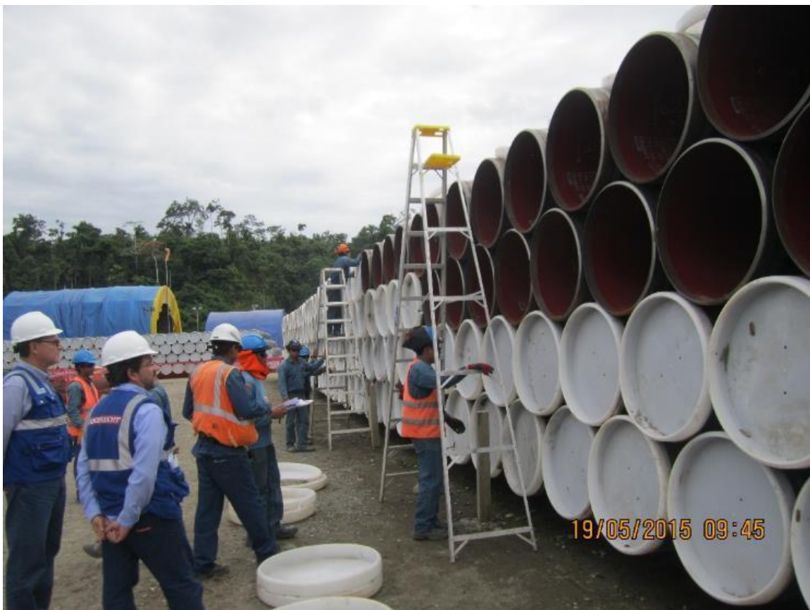
Foto-01: Vista en la cual se aprecia a personal de la empresa Conduto (sub contratista del Concesionario GSP) verificando el estado de los biselos de las tuberías de 32". Labor la efectúan en cada una de las tuberías almacenadas en los acopios.
