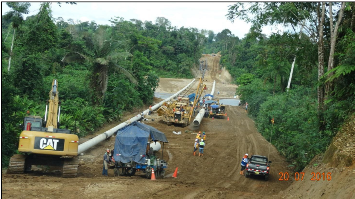
Tramo B – Segmento 1, KP 14+340 Instalación de los ductos de GN y LGN en el río Capanashiari.
