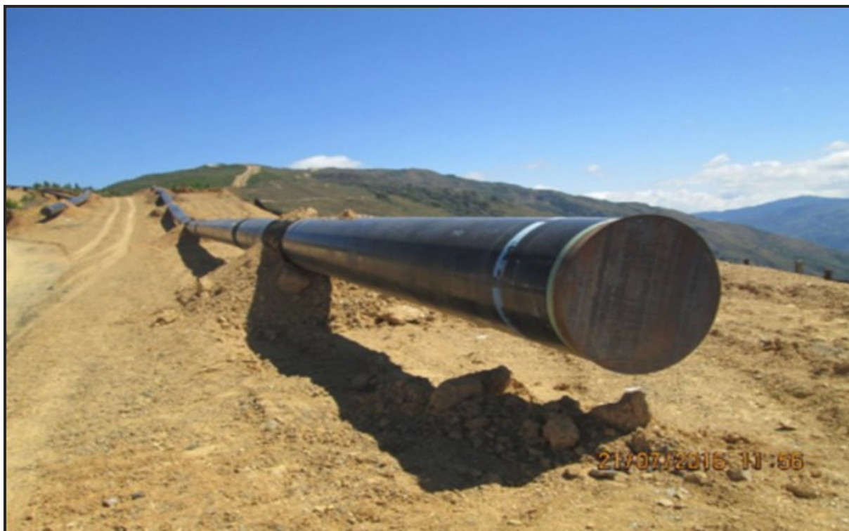
Tramo A1 – Segmento 4, KP 92+939. Verificación de la integridad de la tubería soldada
