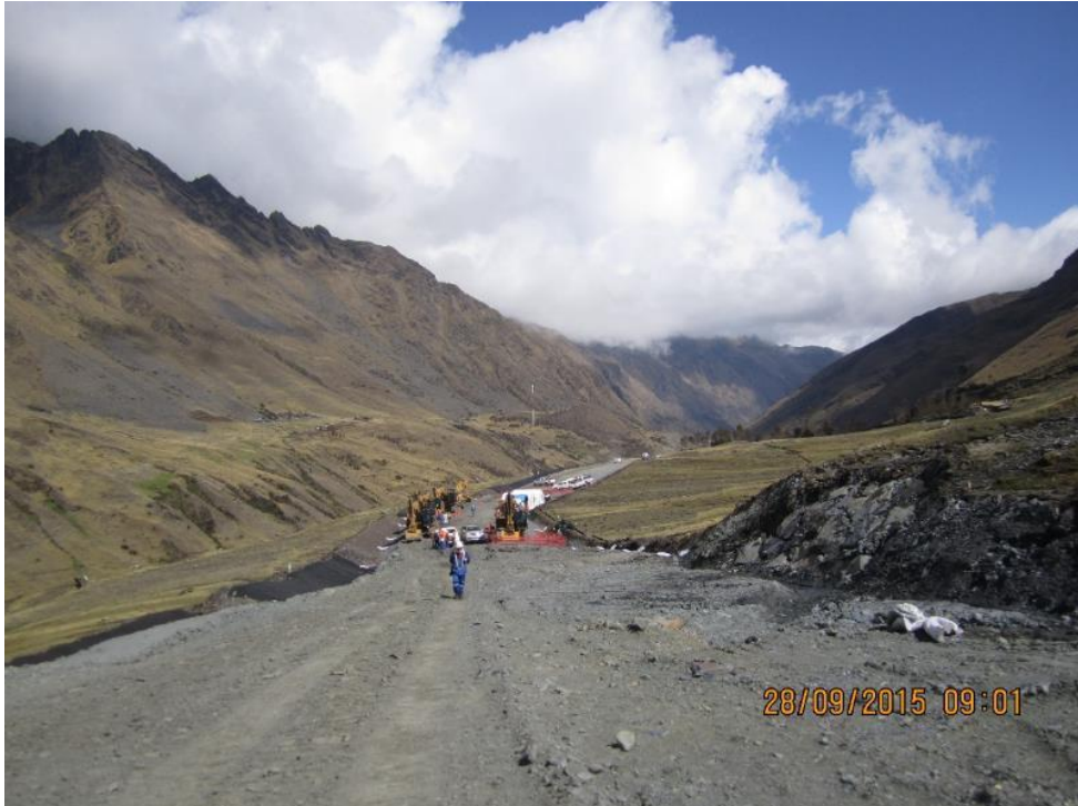
KP. 275+300, vista panorámica en la cual se aprecia parte de la maquinaria utilizada para movimiento de tierras, zanjas laterales (canaletas), nivelación de pista y separación del top soil
