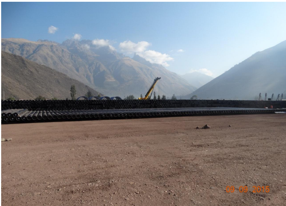
KP 2+094 – Punto de acopio y campamento Calca - Vista panorámica de los tubos de 32" los cuales de acuerdo a la inspección visual estaban sobre una cama de arena cubierta con plástico y los biseles protegidos con tapas plásticas.
