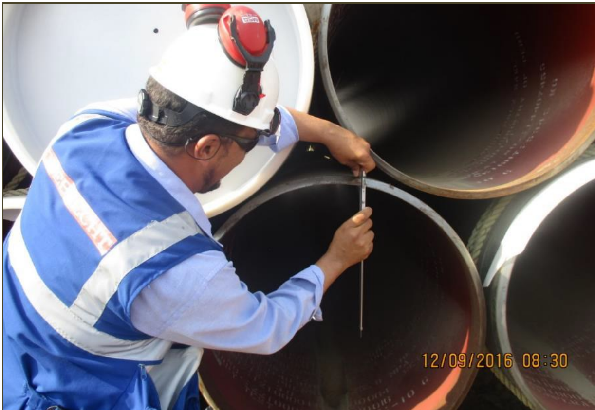
Tramo B – Segmento 01, KP 0014+300 Verificación de la medida del espesor de la tubería de 32”.
