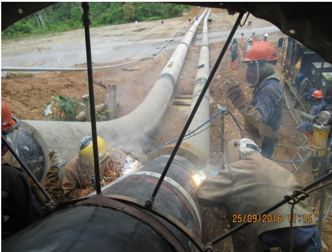
Tramo B – Segmento 01, KP 0017+300 Proceso de soldadura en la tubería de 24"Ø (junta 17/25).
