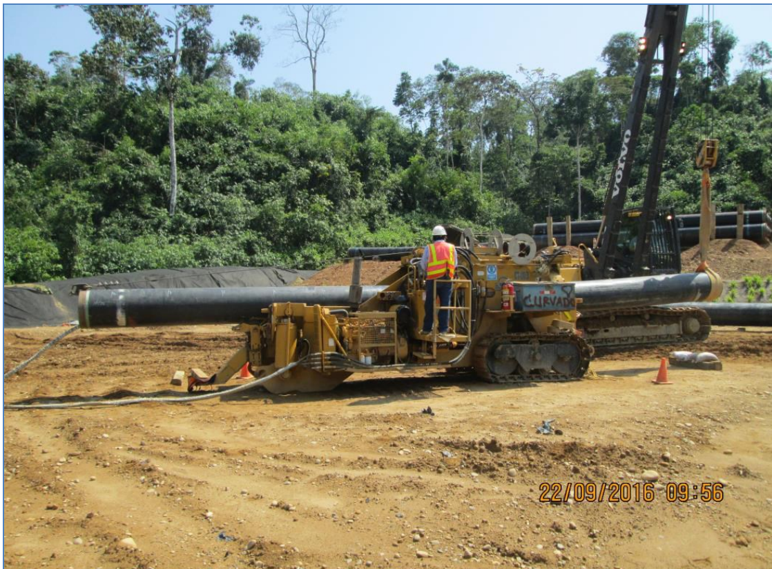
Tramo B – Segmento 01, KP-0017+290. Se aprecia el proceso de curvado del tubo de 24” \varnothing (J14034386).
