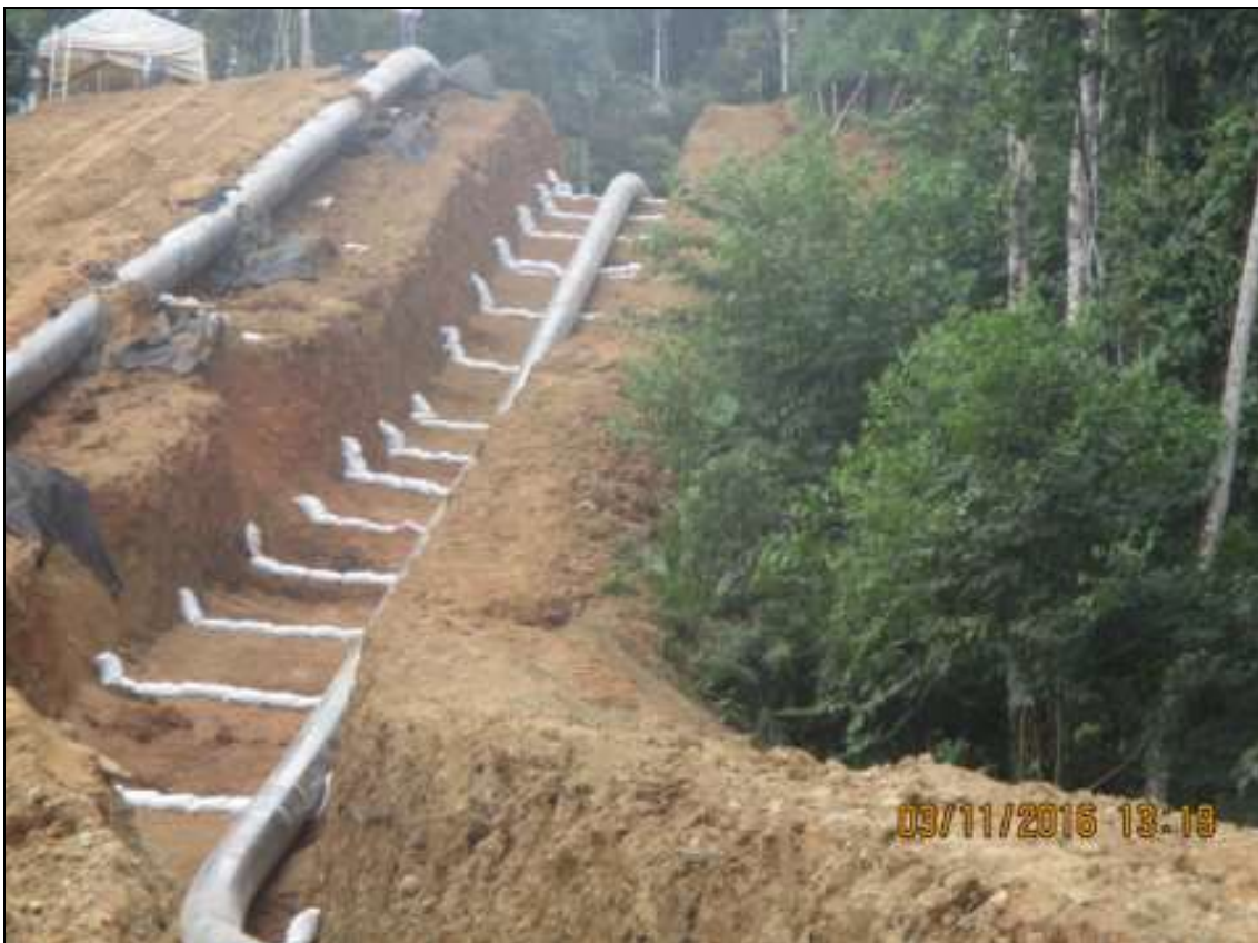
Tramo B – Segmento 02, KP 75+300 Vista de la tubería de 24"Ø dispuesta en zanja.
