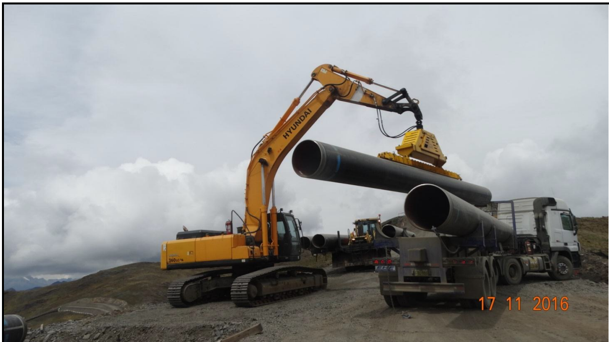
Tramo A1 – Segmento 05, KP 262+000 Transporte de tubos del acopio al Derecho de Vía.
