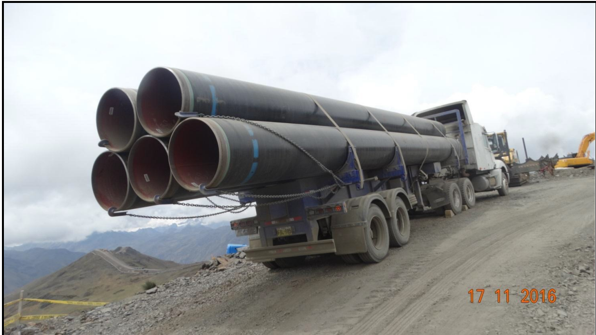
Tramo A1 – Segmento 05 Transporte de tubos del acopio al Derecho de Vía.
