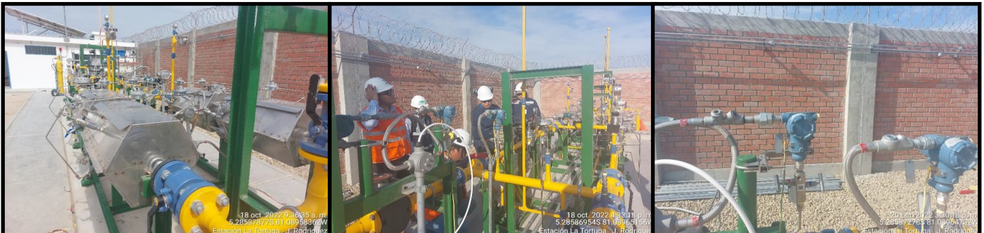
Skid FMR de Estación La Tortuga
