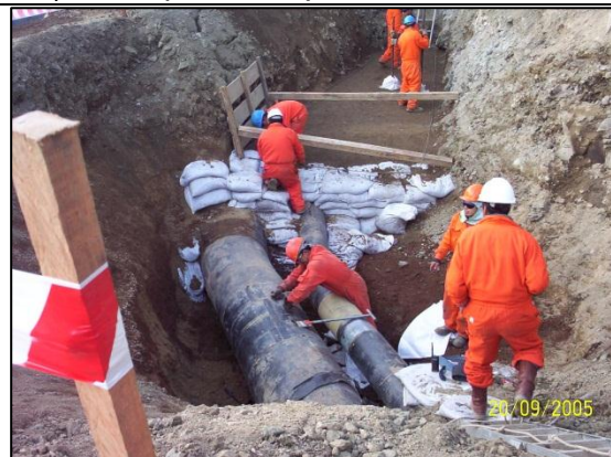
Imagen 08: Vista del ducto de LGN reparado al costado del ducto de GN. (20.09.2005)
