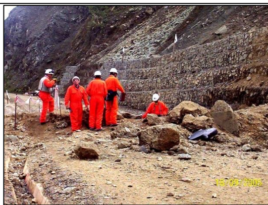
Imagen 05: Vista de la zona donde ocurrió la falla del ducto de LGN. (18.09.2005)
