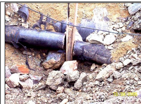
Imagen 04: Vista del ducto fallado en KP 200+700, nótese la separación de 18 cm. entre los extremos del ducto (18.09.2005)
