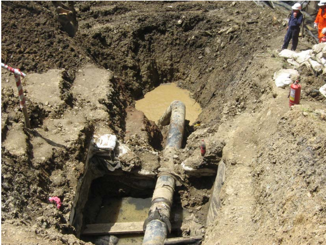
Vista del tramo fallado
