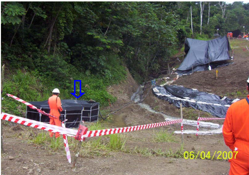
Quebrada natural, flujo de agua superficial y sistema de extracción de LGN desde la zanja hacia el sistema de tanques - fast Tank's,- flecha azul.
