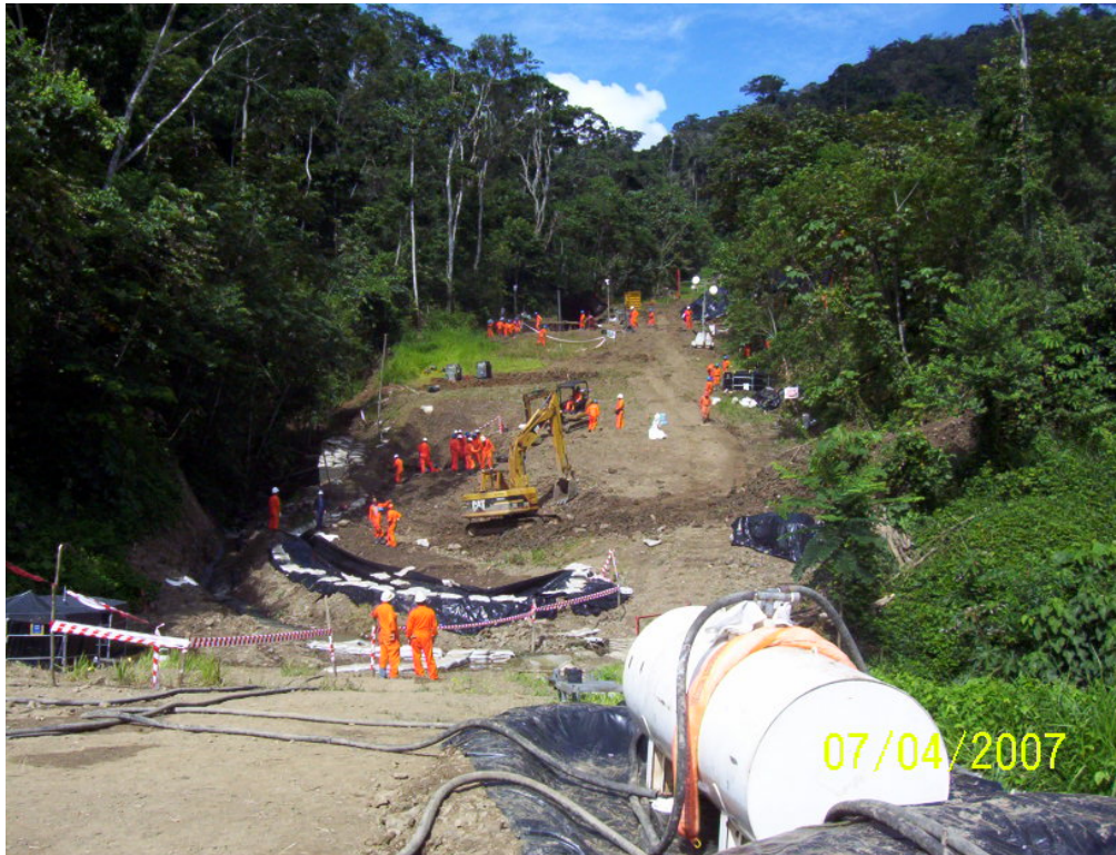
Vista Panorámica de la zona de la falla
