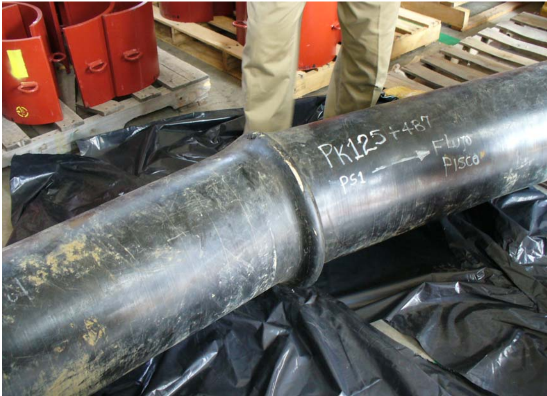
Vista del pliegue en tramo fallado
