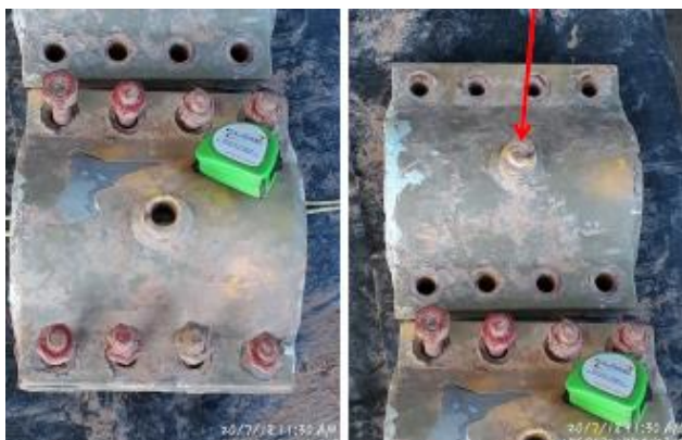
Figura 04: vista de las grampas retiradas de la zona de emergencia KP 81+550.
