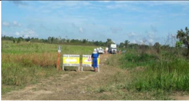
Figura 06: KP 81+550, vista de la zona de trabajo donde se realizan las actividades de reparación, a la llegada de la supervisión de Osinerghmin.
