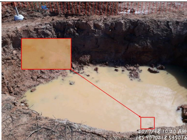
Figura 02: KP 81+550, Vista de la zona donde ocurrió la emergencia. El derrame está controlado, AEP cambió la grampa dañada por una nueva (certificada). El agua en el hoyo es debido a las lluvias permanentes. Se observa el perno de la grampa, que apenas asoma y no se vio burbujeo. El monitoreo continuo no da muestras de pérdida de LGN.
