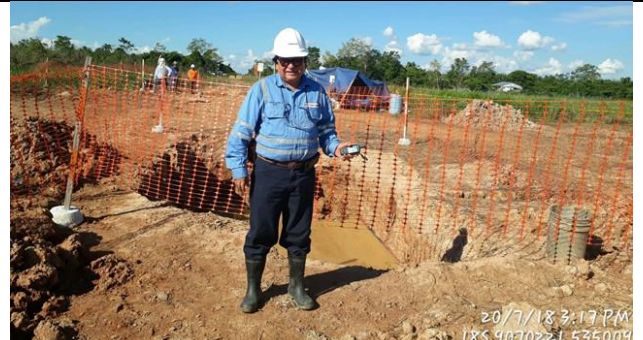
Figura 07: KP 81+550, Especialista de Osinerghmin en la zona donde ocurrió la emergencia.
