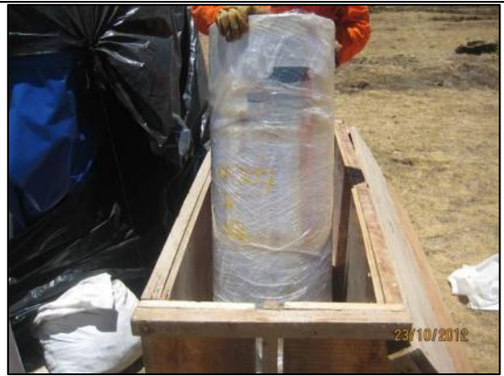
Imagen 17: Tramo afectado (niple) empaquetado con cinta plástica adherible. (23.10.2012)
