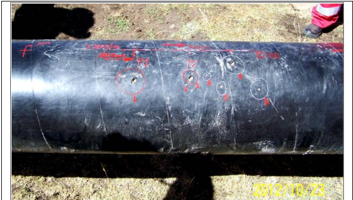
Imagen 11: Vista del ducto de LGN de 14", se observan las 07 perforaciones realizadas en la pared de la tubería.
