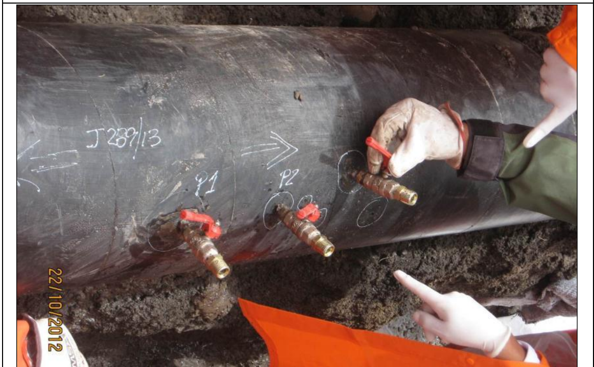
Imagen 12: Vista de las 03 válvulas encontradas en las inmediaciones de la tubería perforada, las cuales al ser ubicadas en las perforaciones mayores, éstas encajaron.
