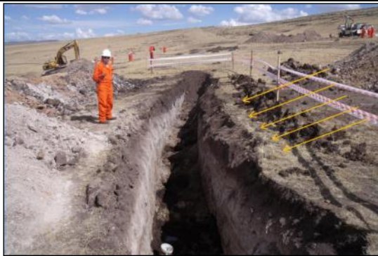
Imagen 08: Zanja de contención ubicada a 20 metros de la filtración de LGN
