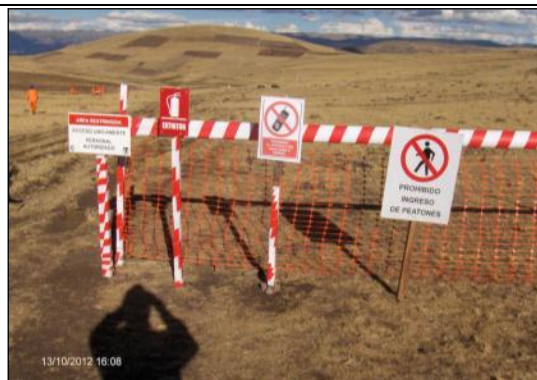
Imagen 04: Demarcación de zona de peligro e instalación de letreros de seguridad. (13.10.2012)
