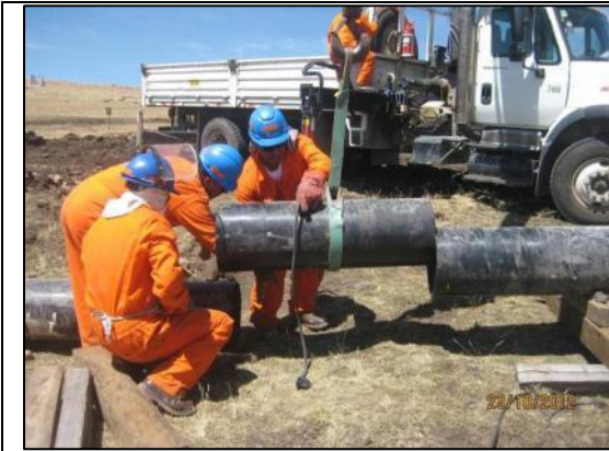
Imagen 16: Corte de la sección afectada. El niple extraído tiene una longitud de 1.10 metros (23.10.2012)
