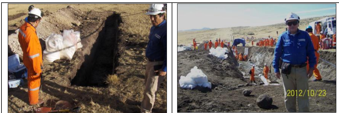
Imagen 09 y 10: Presencia permanente de OSINERGMIN en la zona del incidente.
