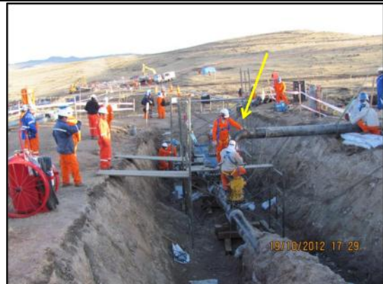
Imagen 15: Vista en la que se aprecia extremo del By-Pass (flecha amarilla) ubicada aguas abajo del punto de anomalía. (18.10.2012)
