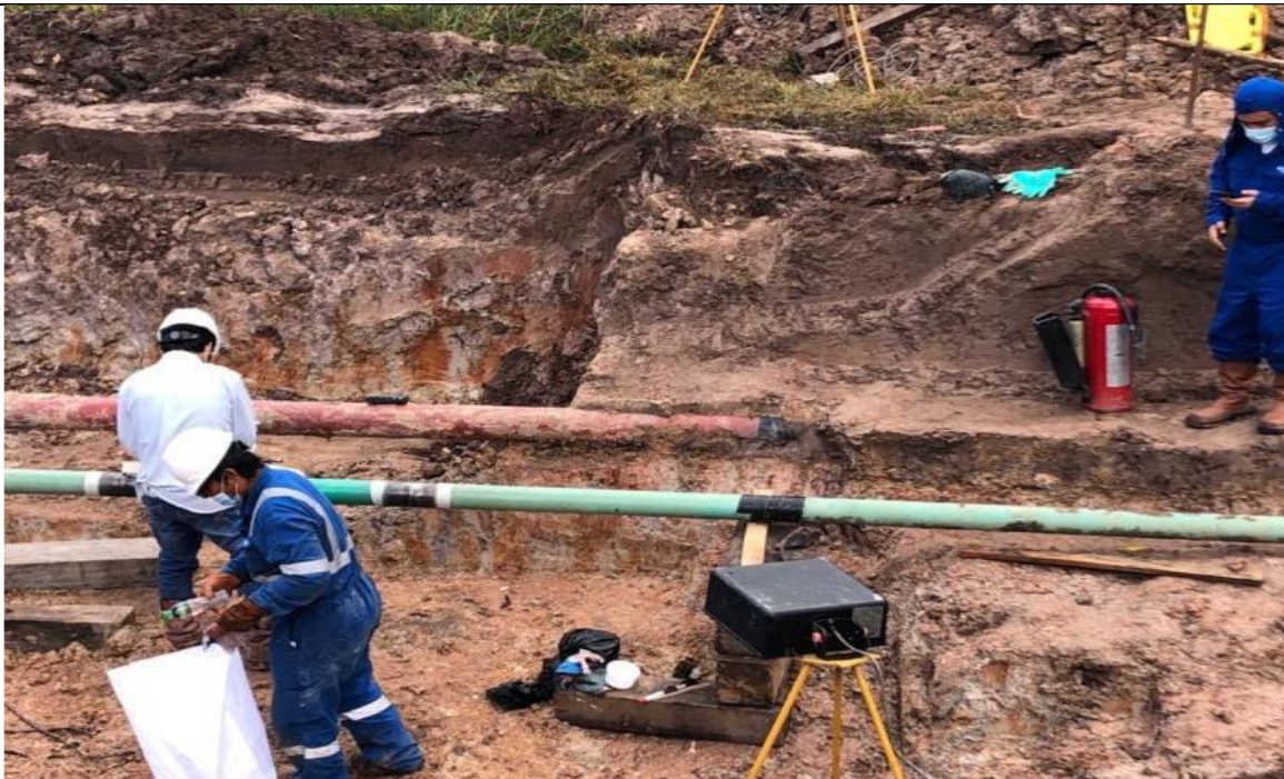
Figura 05: Vista de finalización de trabajos de reparación del segmento del ducto de LGN afectado. Fuente: AEP
