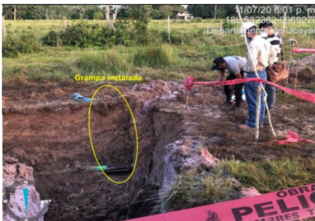
Figura 02: KP 78+400 - Vista del lugar del evento suscitado el 04 de julio de 2020. Se observa una conexión clandestina (grampa) para la sustracción de LGN.
