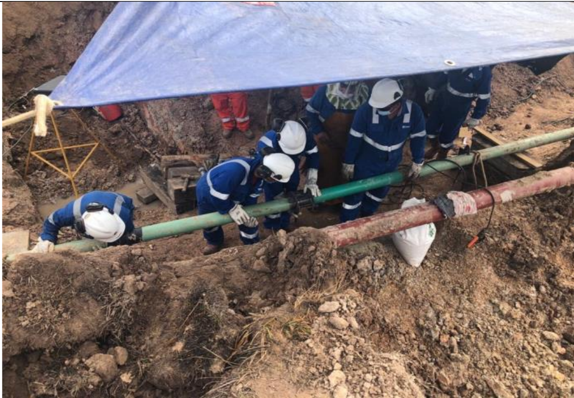
Figura 04: Vista de trabajos de reparación del segmento del ducto de LGN afectado. Fuente: AEP
