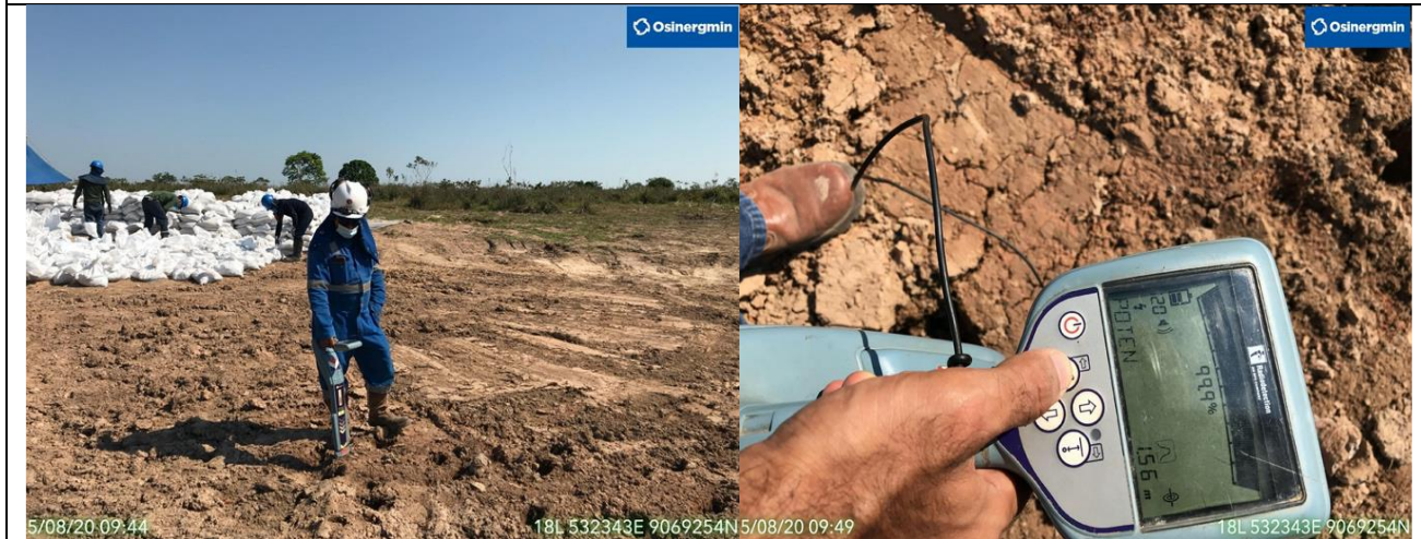
Figura 13: Vistas de la medición de la tapada en el punto de falla a la altura del KP 78+400 del ducto de LGN de 4" Tramo Neshuya – Planta Fraccionamiento, donde se evidencia una tapada de 1.56m
