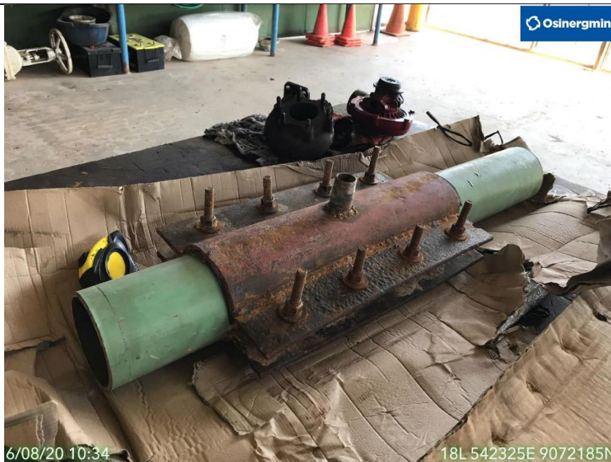
Figura 10: Vista del niple encontrado en el ducto de 4" de LGN del Tramo Estación Neshuya – Planta Fraccionamiento (KP 78+400), de aproximadamente 90 cm, el cual fue instalado de manera clandestina por terceros para el hurto de LGN.
