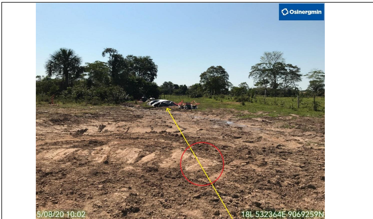
Figura 12: Vista del punto de falla a la altura del KP 78+400 del ducto de LGN de 4" Tramo Neshuya – Planta Fraccionamiento, se verifica Derecho de Vía reconformado.
