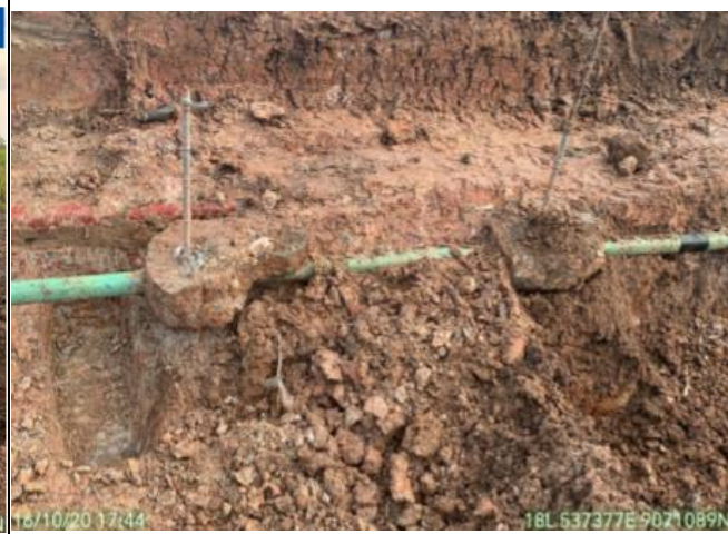
Figura 06: Vista del ducto de 4” de LGN liberado después de actividades de excavación, se visualizan las dos válvulas perpendiculares al ducto en el KP 83+970 las cuales fueron instaladas de manera clandestina, ocasionando el derrame de hidrocarburo.
