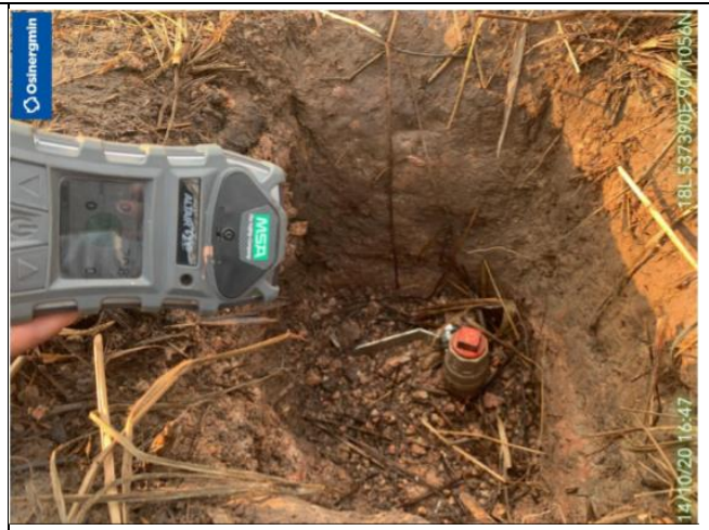
Figura 04: KP 83+970 – Vista del lugar del evento suscitado el 10 de julio de 2020. Se evidencia la segunda instalación de una válvula de 1” en el ducto de LGN, la cual se encuentra a 1.5m aguas debajo de la primera instalación.
