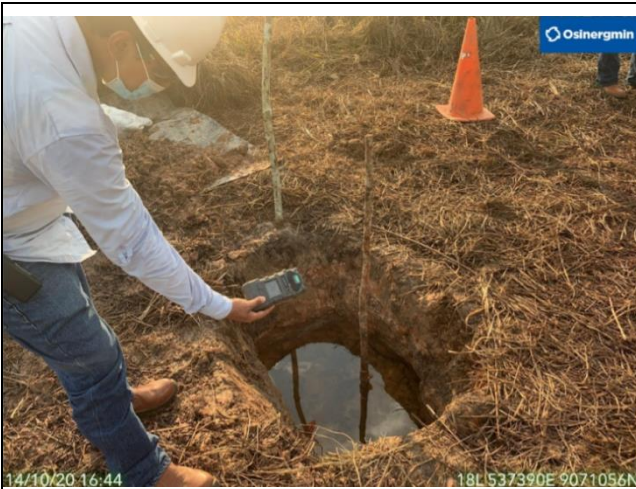
Figura 03: KP 83+970 – Vista del lugar del evento suscitado el 10 de julio de 2020. Se evidencia la primera instalación de una válvula de 1” en el ducto de LGN.
