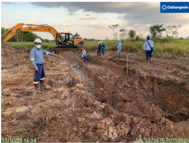
Figura 05: Verificación de los trabajos de excavación para liberación de ducto como parte de las actividades de reparación de la falla presentada en el KP 83+970. Ducto de 4” LGN.
