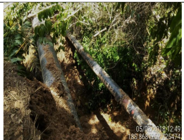
Imagen 04: KP 09+070, Vista de tuberías expuestas de GN y LGN, en una longitud de 10 metros. (05.02.2018)
