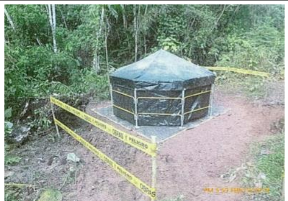
Imagen 10: KP 8+900, Fast tank para almacenamiento de residuos sólidos, instalado en la zona del evento.
