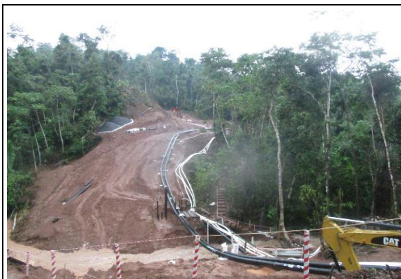
Imagen 26: KP 8+900, vista de las líneas de bypass de GN, con tubería rígida de 14".
