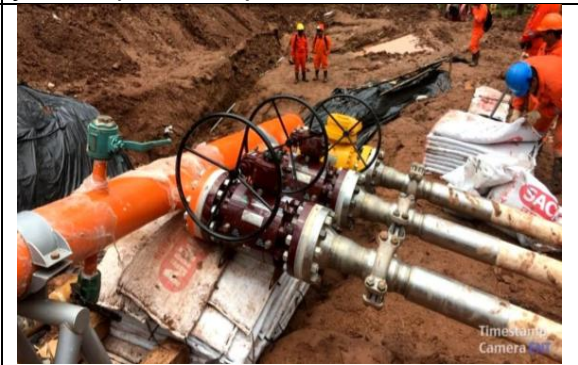
Imagen 25: Vista general de la derivación, lado Malvinas, del bypass instalado. (15.02.2018)
