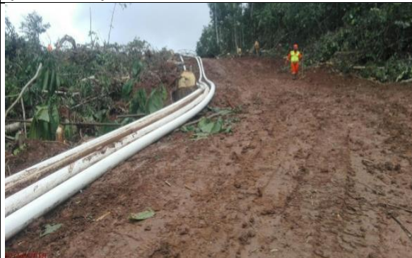
Imagen 24: Vista del tendido de las tres (03) líneas de tubería flexible de 6", a lo largo de la variante. (14.02.2018)
