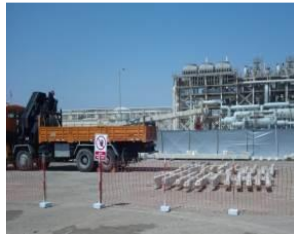
Foto 4. Vista de prefabricados para soportería de tuberías
