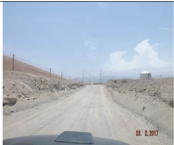
Foto 2. Vista Panorámica de los trabajos de acondicionamiento de terreno para el acceso de los camiones cisternas al cargadero de GNL
