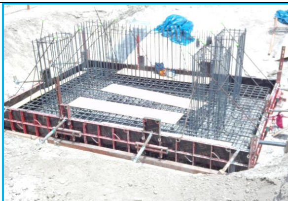
Foto 3. Armadura de la cimentación para puente N° 2 de la soportería de tubería
