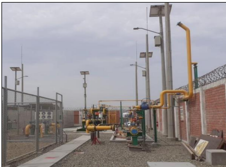
Foto: Se observa los skid de regulación y medición de la estación de Piura
