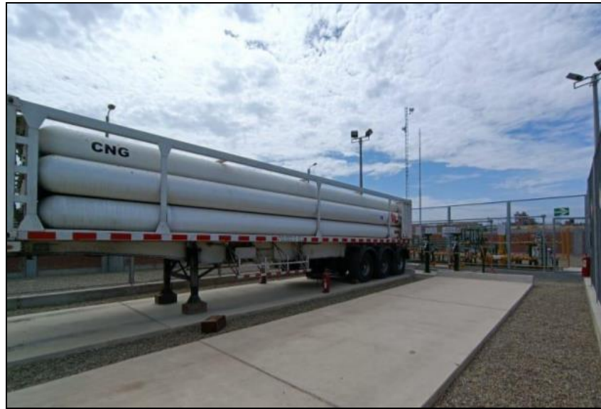
Foto: Se observa la Zona de almacenamiento de GNC - Estación de Sullana
