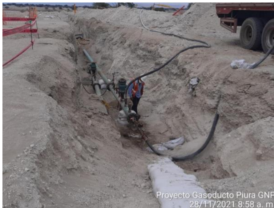
Foto: Se aprecia el manifold para realizar la prueba hidrostática al gasoducto. Corresponde al tramo 12 del gasoducto.
