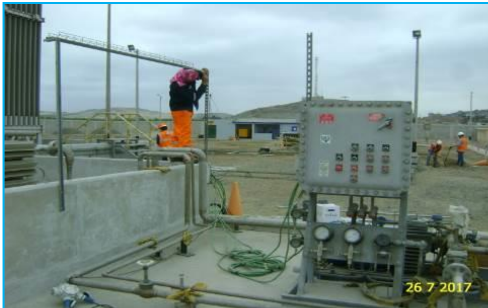
Foto 05.- Vista Estación de Distrito de Chimbote. Zona de bombas de trasiego de GNL.
