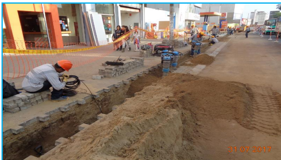
Foto 08.- Redes Trujillo , vista de la Instalación del cable conductor eléctrico y trabajos de compactación del terreno. Ref.: Av. América Sur, Cdra. 13.
