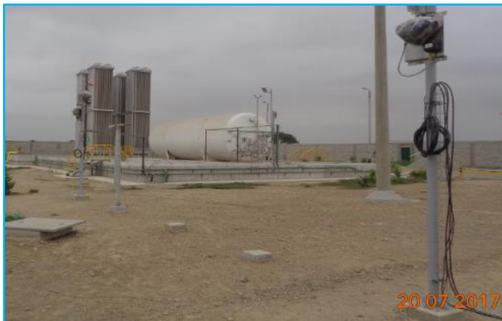
Foto 04.- Vista de la Estación de Distrito de Chiclayo
