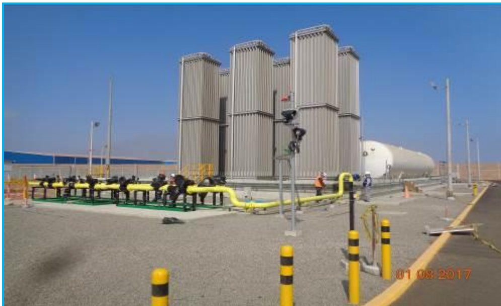
Foto 01.- Vista de la Estación Distrito de Trujillo, zona de la ERM.
