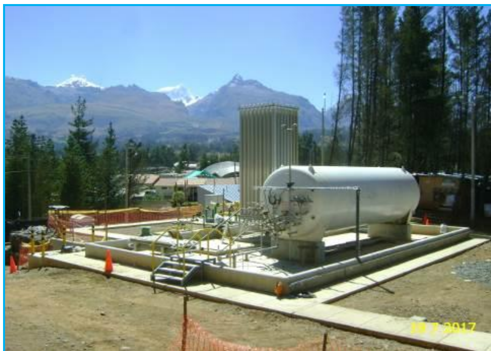
Foto 06.- Vista de Estación de Distrito de Huaraz.
