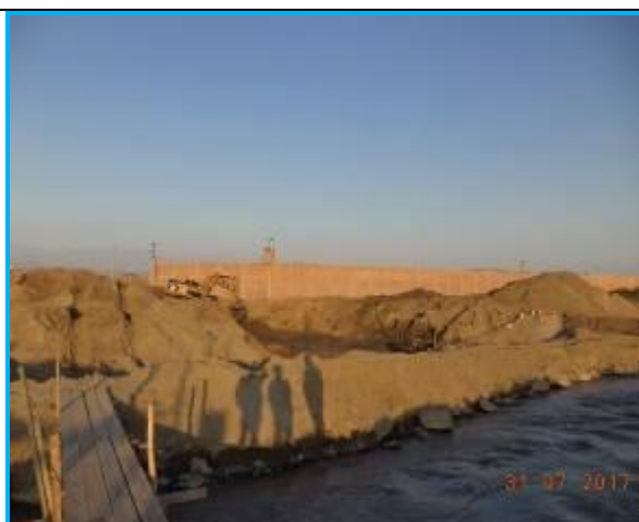
Foto 17.- Redes Chimbote, excavación de talud del río para completar con el cruce especial del Río Lacramarca.
