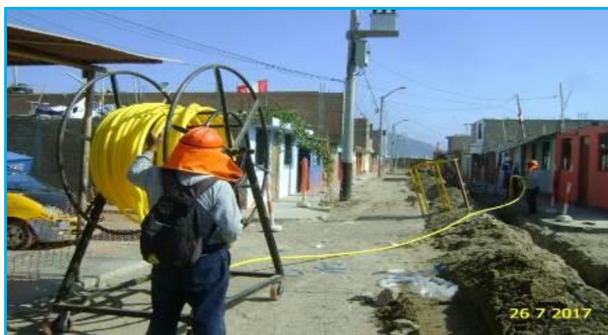
Foto 10.- Redes Chimbote: Instalación de tubería de PE Ø32 mm. Calle 5 de Nuevo Chimbote.
