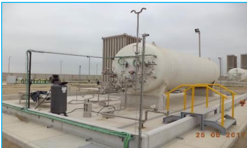
Foto 03.- Vista de Estación de Distrito de Lambayeque
