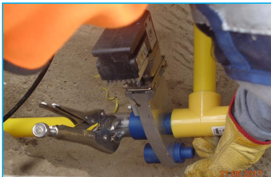
Foto 09.- Redes Trujillo, junta a socket por termofusión, inspección de la aplicación de los parámetros de temperatura y tiempo de acuerdo a sus procedimientos
