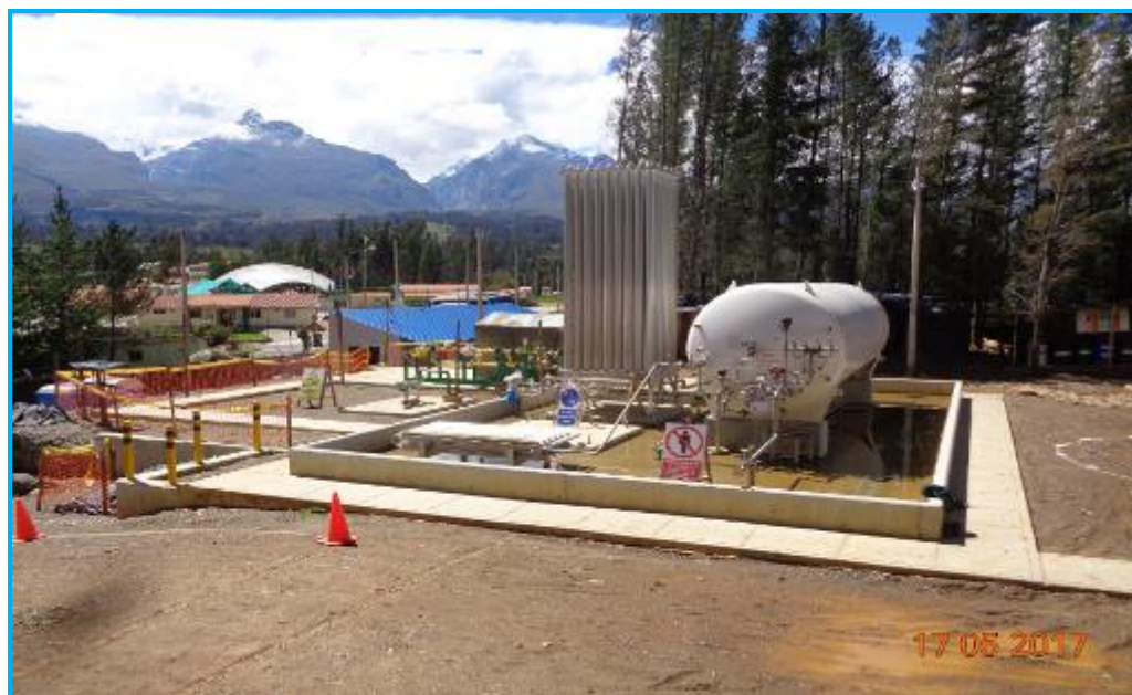
Foto 06.- Vista de Estación de Distrito de Huaraz.
