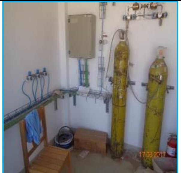
Foto 15.-Pacasmayo, vista de las instalaciones en el almacén de Nitrógeno.
