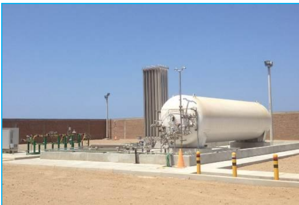
Foto 02.- Vista de la zona de procesos de la Estación de Distrito Pacasmayo.
