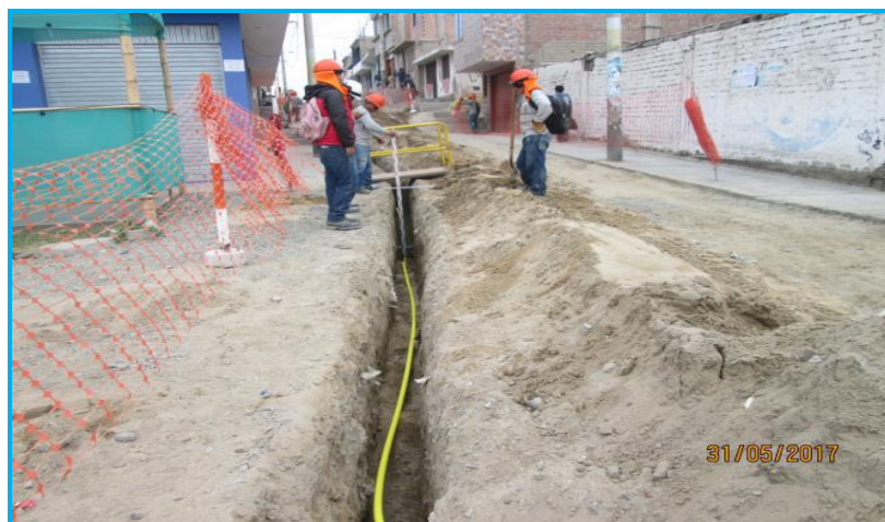
Foto 11.- Redes Nuevo Chimbote, Verificación de las distancias de seguridad.
