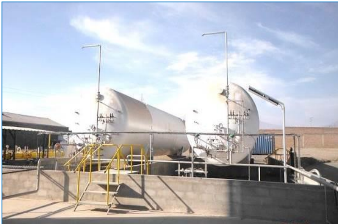
Foto 02.- Vista de la Estación de Distrito AREQUIPA SUR
