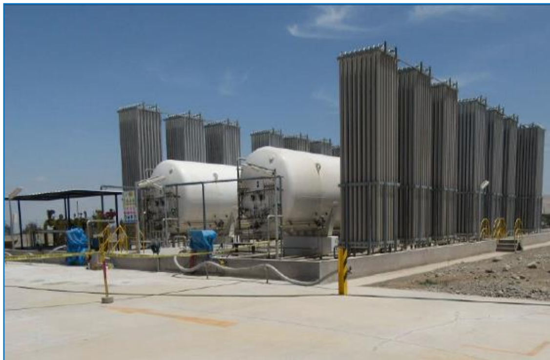
Foto 04.- Vista de la Estación de Distrito TACNA
