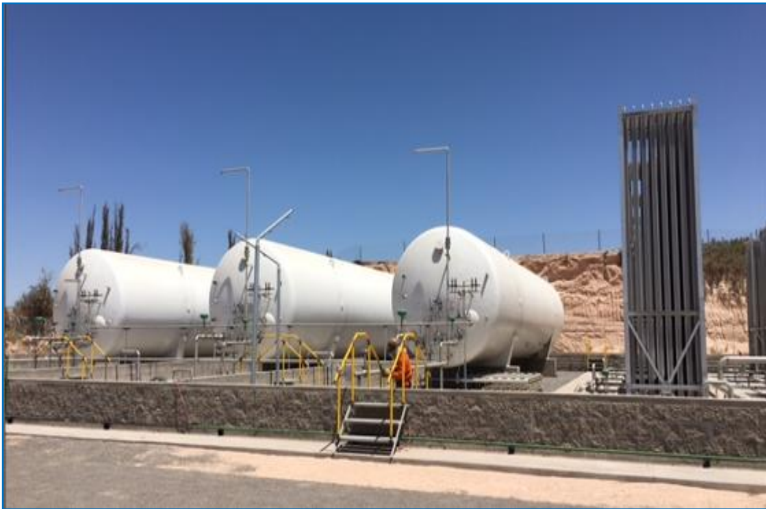
Foto 01.- Vista de la Estación de Distrito AREQUIPA NORTE
