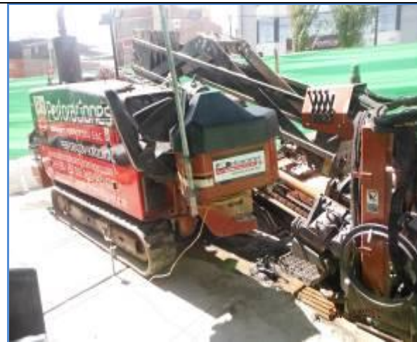
Foto 14.- Redes Arequipa: Equipo de perforación horizontal dirigida para cruce especial ubicada en la Av. Malecón Dolores.
