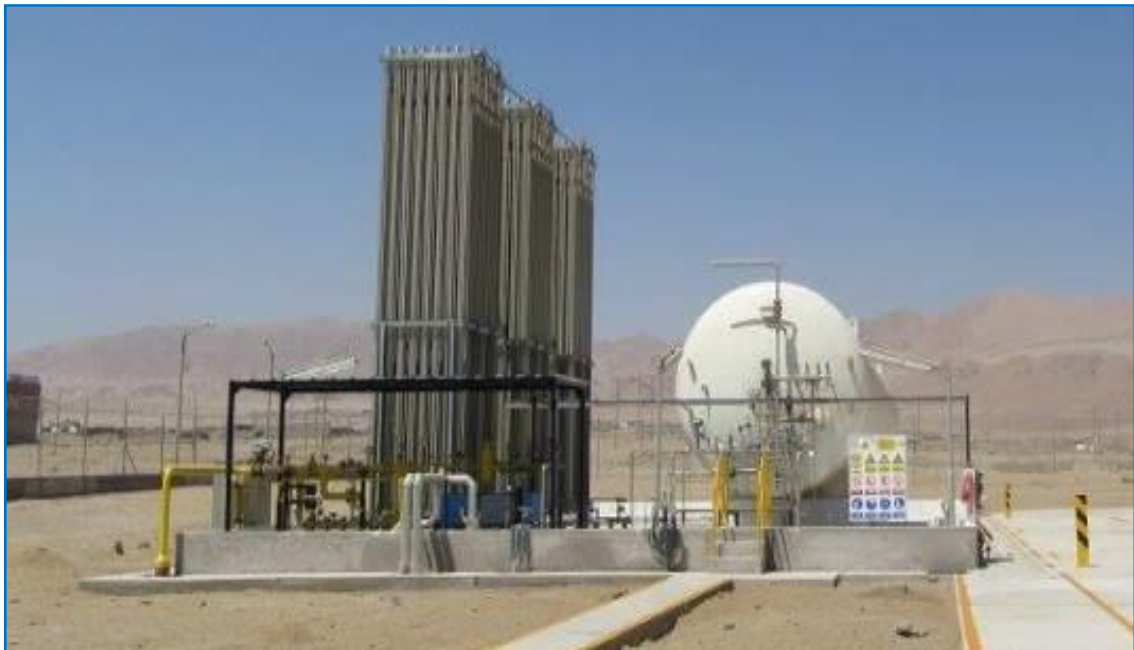
Foto 05.- Vista de la Estación de Distrito ILO
