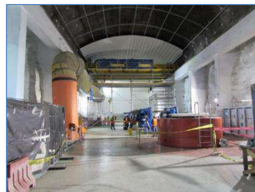
Casa de Máquinas (en caverna)
