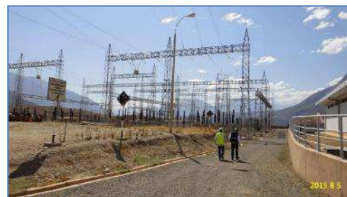
S.E. Kiman Ayllu (220 kV)
