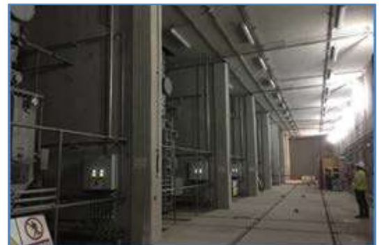
Caverna de Transformadores (9 Transformadores)
