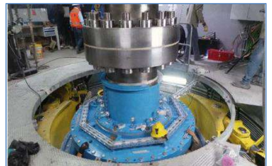
Casa de Máquinas (Turbina de la Unidad 1)
