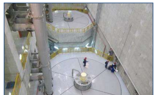
Unidades 1 y 2 de la Casa de Máquinas principal
