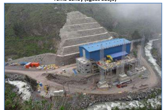
Casa de Máquinas y Subestación
