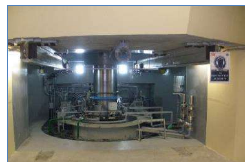
Eje de Acoplamiento Turbina-Generador Eléctrico
