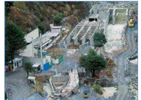
Barraje, Bocatoma, Desarenador y Canal de Conducción
