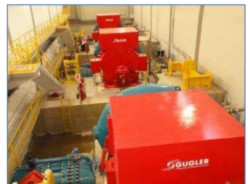
Sala de Máquinas (3 turbinas de 6,56 MW)
