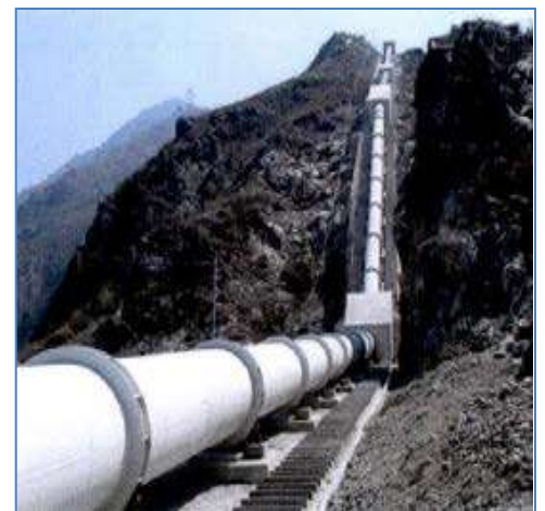
Tubería Forzada – C.H. Huasahuasi I
