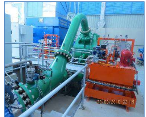
Turbina y unidad de presión hidráulica
