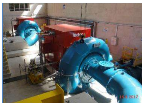
Casa de Máquinas con dos Turbinas Francis
