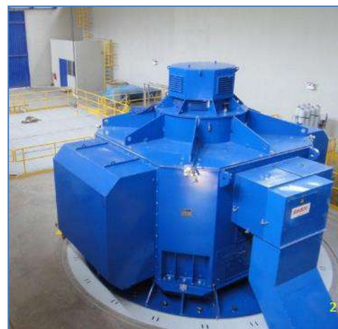
Casa de Máquinas – Generador eléctrico INDAR
