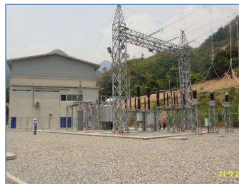
Vista de la Casa de Máquinas y Subestación
