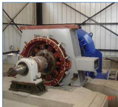
Turbina y Generador Eléctrico
