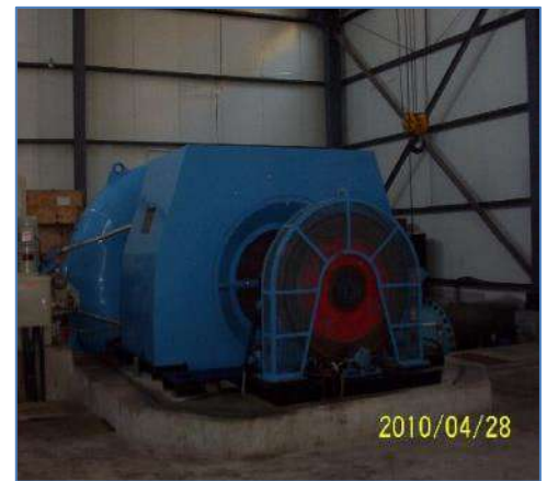
Unidad de Generación
