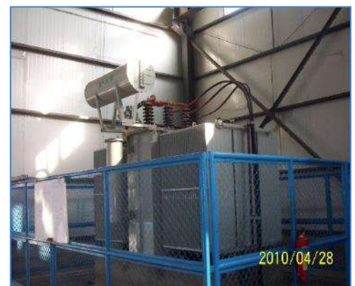
Transformador de Potencia
