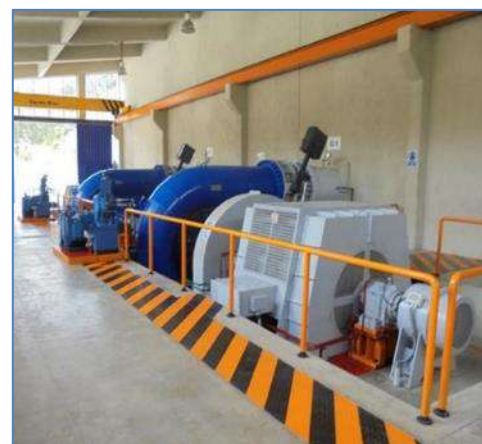
Interior de Casa de Máquinas
