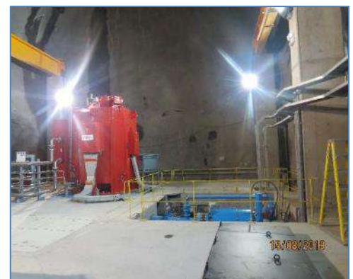
Generador 2 y válvula esférica
