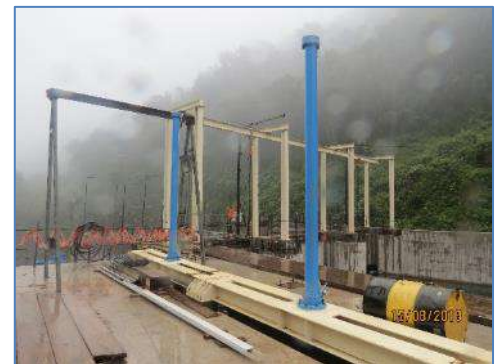
Cilindros de canales 1 y 2
