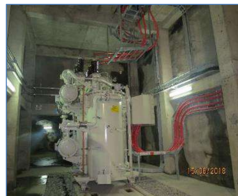
Transformador 6,6/33 kV – 25 MVA
