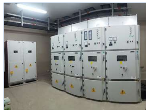
Sala de control – primer nivel
