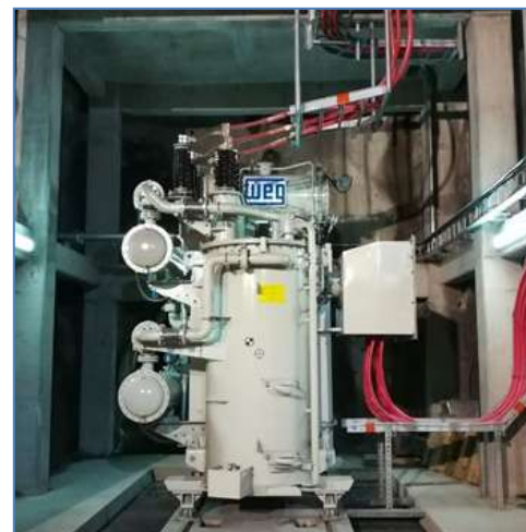
Transformador de 25 MVA
