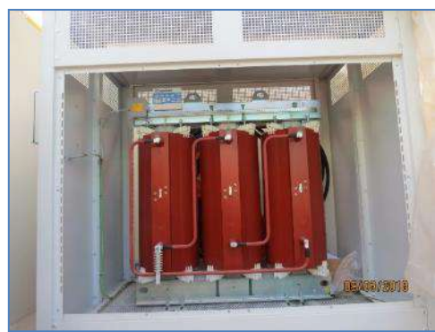
Transformador trifásico seco 0,4/10 kV
