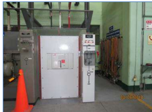
Celda de 10 kV – Punto de Conexión
